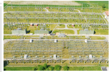
Luftbild Umspannwerk Schmölln
